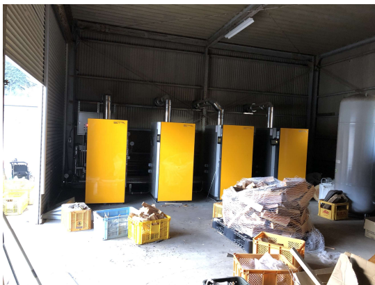
木質バイオマスボイラー
