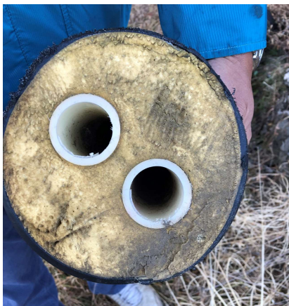
断熱材で覆われた配水管
